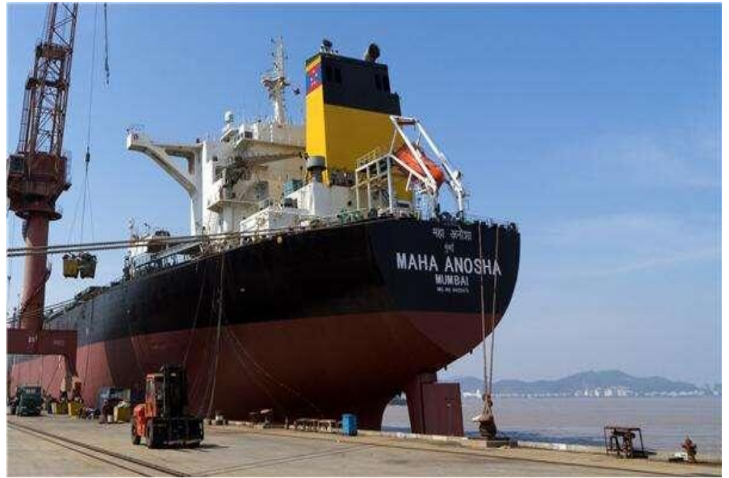
图表3：船舶安装脱硫塔
